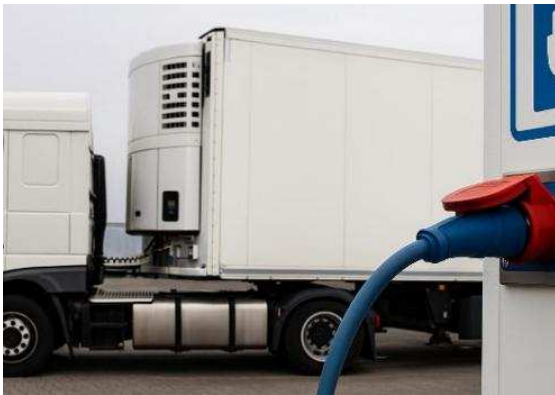
Stromsäule (TSE) für externe Stromversorgung
