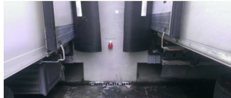
Beispiel: einzelner Stromanschluss in einem Logistikzentrum
